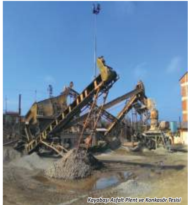
Kayabaşı Asfalt Plant ve Konkasör Tesisleri
